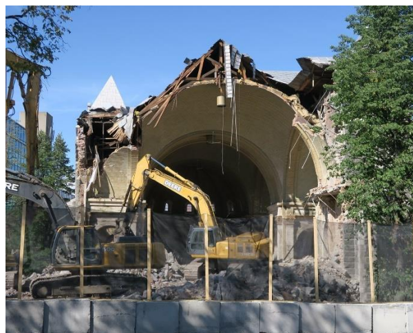
20. La voûte Gustavino, dont la structure a été révélée lors de la démolition de l'église Saint-Cœur-de-Marie en septembre 2019 (© Claude Thibault).
